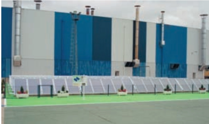
Foto 9.4. Instalación solar térmica en Valladolid (I).
