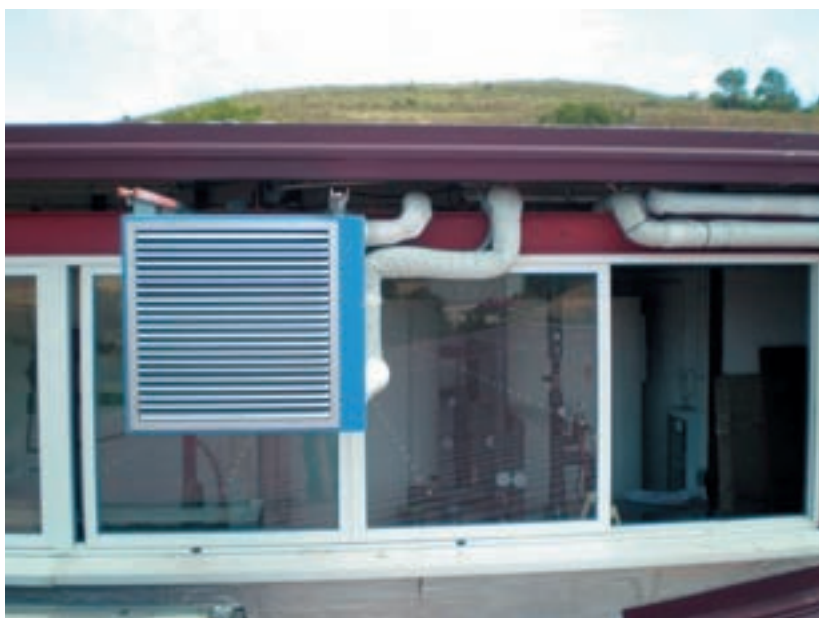
Foto 9.10. Circuito de captadores solares.
