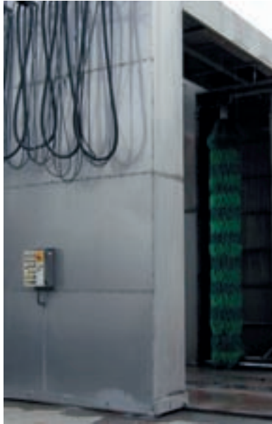
Foto 2.3. Túnel de lavado.
