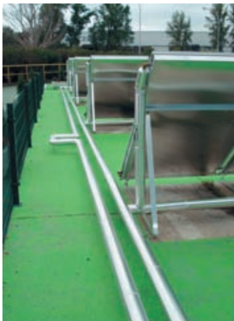
Foto 9.5. Instalación solar térmica en Valladolid (II).
