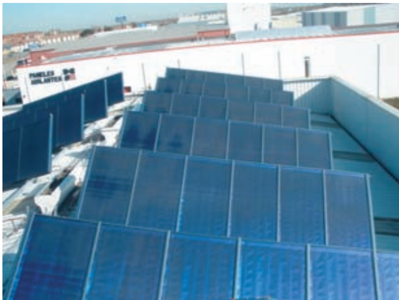
Foto 9.1. Captadores solares térmicos.
