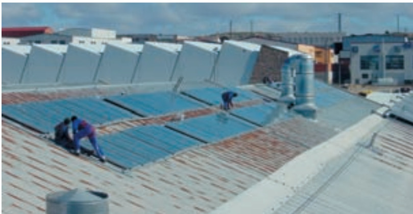
Foto 2.6. Instalación solar industrial.
